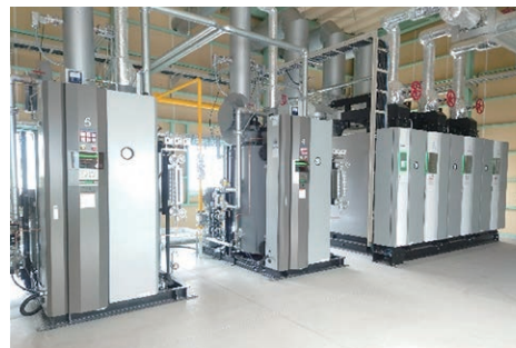
新ボイラー室
